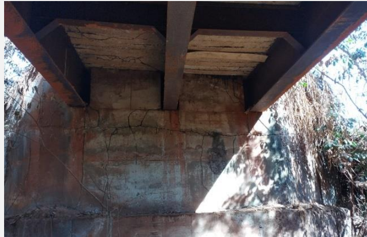
Imagem 40 – Ponte a ser recuperada
