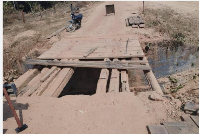
Imagem 39 – Ponte a ser recomposta
